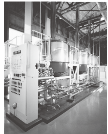
工場仕込み設備
